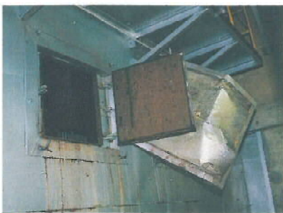
爆風で開いた点検口 (外側の扉が変形しています)
