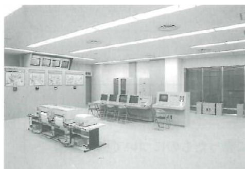
中央制御室 各機器の稼動状態を監視し、ここで集中コントロールします。
